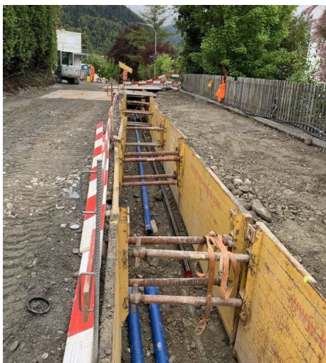
Wasser- und Gasleitung
