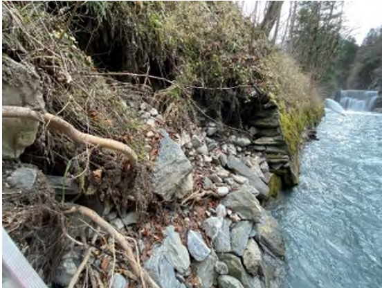
Ausgespülte Wuhrmauer km 3.6
