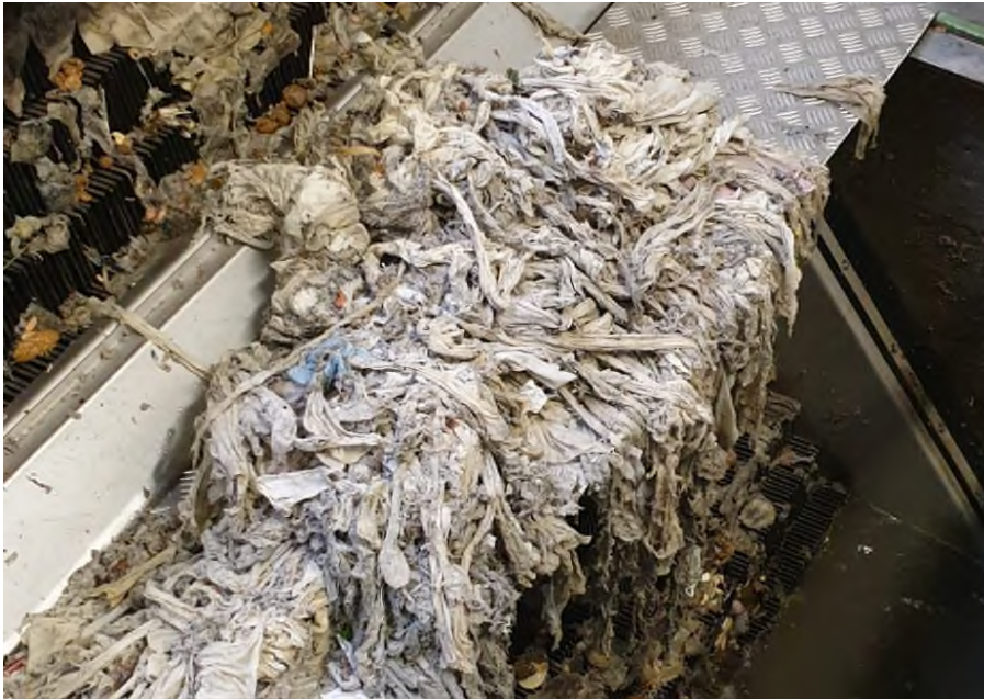
Feuchttücher im Zufluss der Rechenanlage
