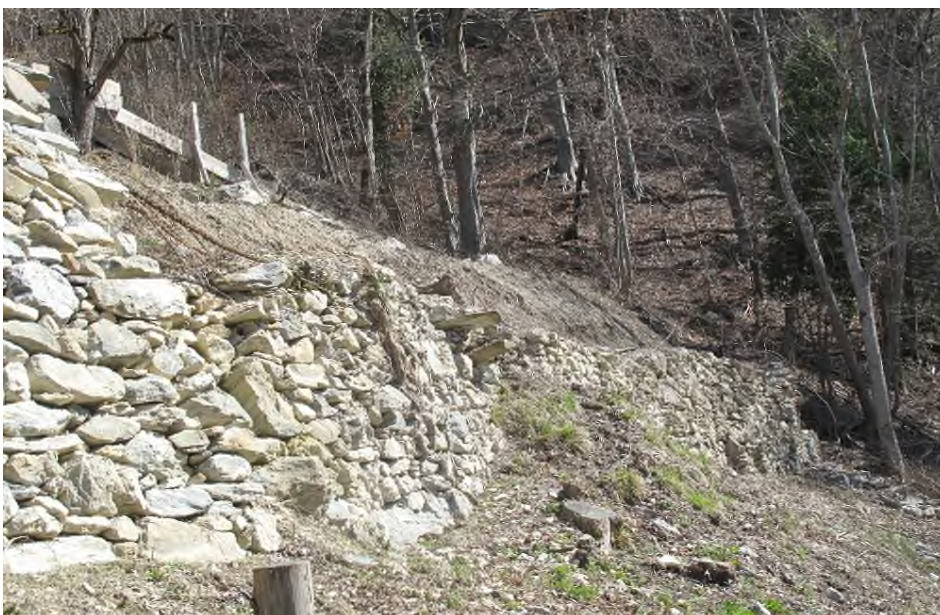
Defekte Trockenmauer im Seidengut vor der Sanierung
