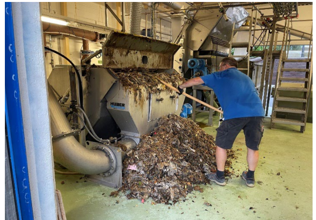
Starkregen mit hohen Grobstoffanteilen führte zu Tunnelbildung Rechengutwaschpresse
