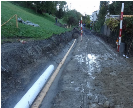
Sickerleitung für Hangwasser
