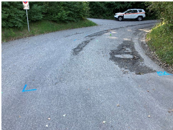
Belagsschaden an Fahrbahn
