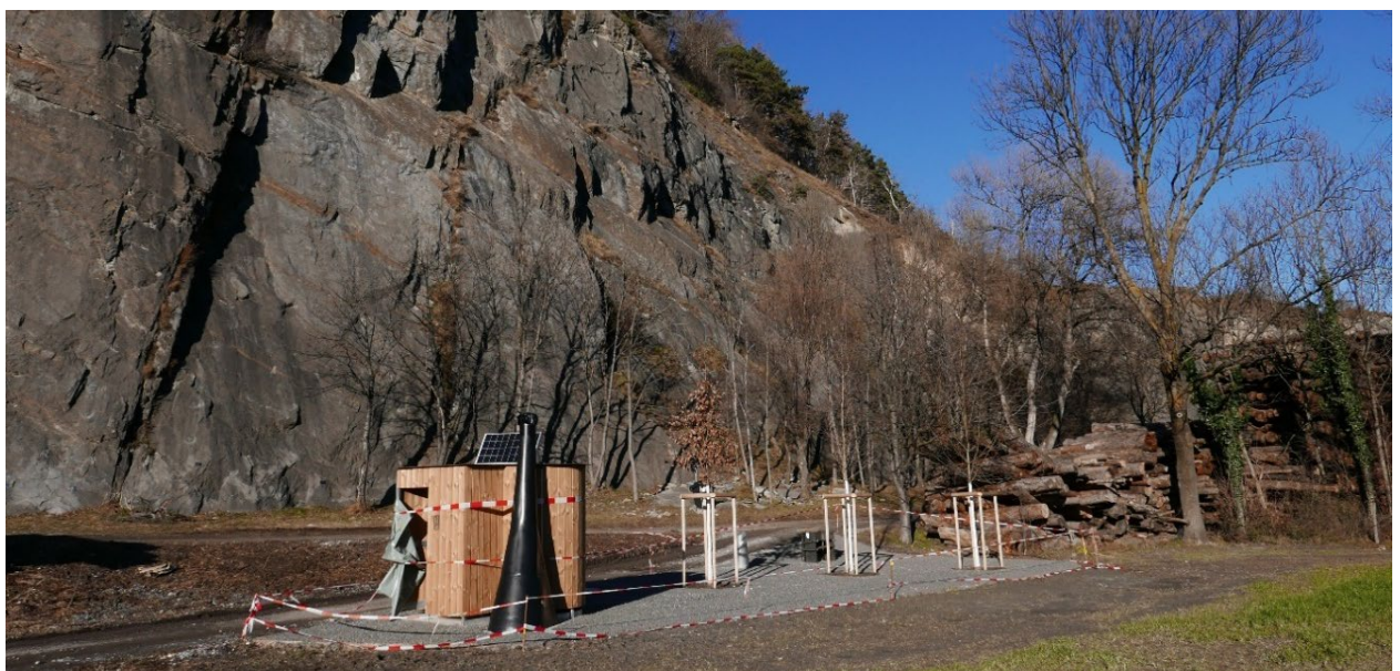
Bau und aktueller Zustand Sitzplatz Klettergarten Haldenstein mit Toilette
