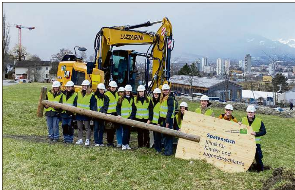
Am Mittwoch haben Lernende der Psychiatrischen Dienste Graubünden den Spatenstich für die neue Klinik für Kinder- und Jugendpsychiatrie vorgenommen. Bild zVg
