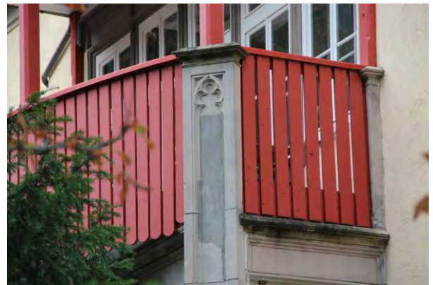
Laubenbrüstung mit gotisierendem Pfeiler auf der SO-Seite, Brüstungsbretter nicht in ursprünglicher Form
