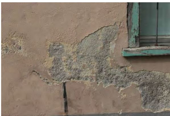
Putzschaden infolge falschen Anstrichs
