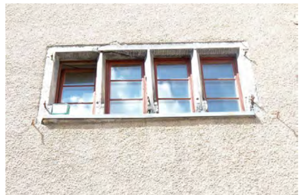
Detailaufnahme Fenster 2.Obergeschoss (Risse und Substanzverlust an den Voluten)
