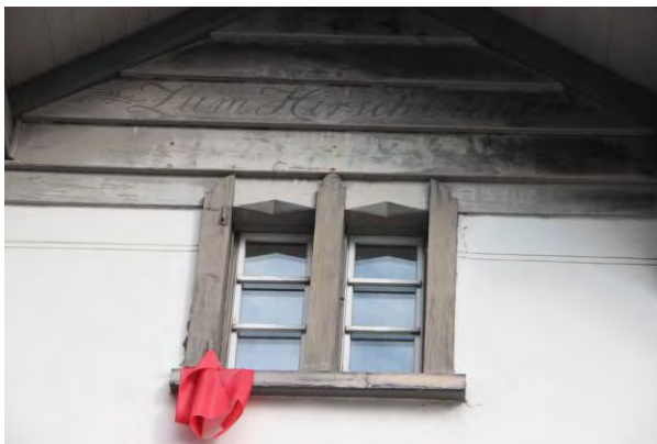
Fenster im Giebfeld mit eigenwilliger Kerbung
