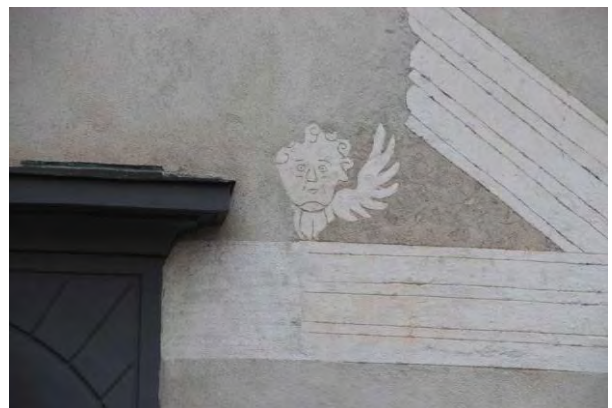
Das Sgraffitofragment neben der Eingangstüre deutet auf eine frühere Tür- oder Fensteröffnung hin
