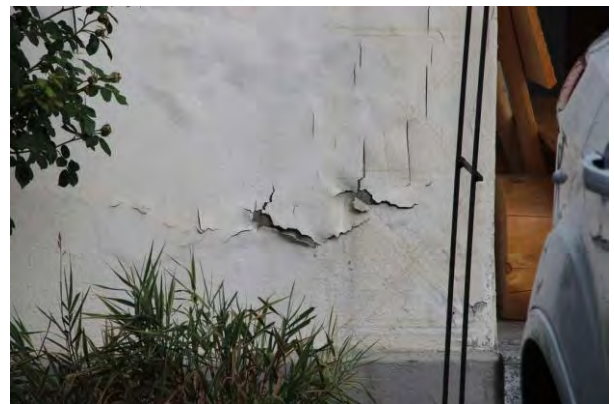
Schaden an der Hauswand durch falsche Materialwahl bei der letzten Renovation
