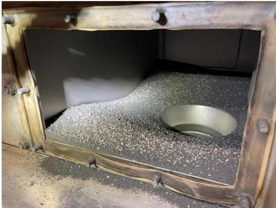
Unter dem Düsenboden des Trockners, Kies und mineralische Stoffe im getrockneten Klärschlammgranulat
