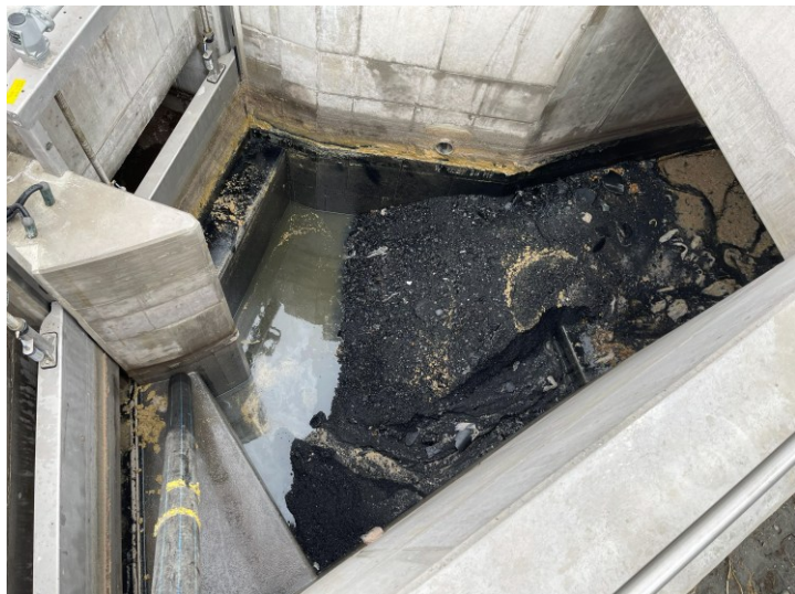
Neuer Stein- und Kiesfang mit über 10 m 3 Fassungsvermögen
