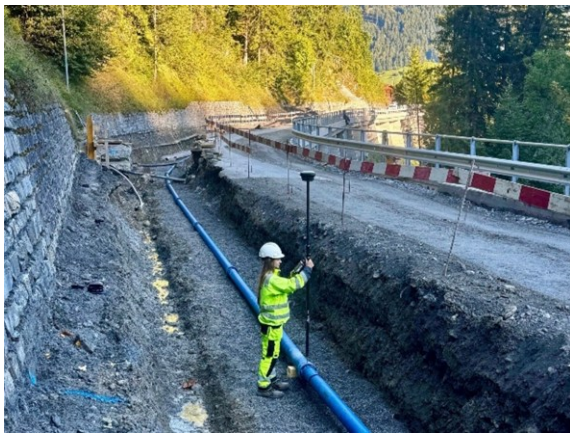
Sagatobel Praden, Aufnahme Wasserleitung
