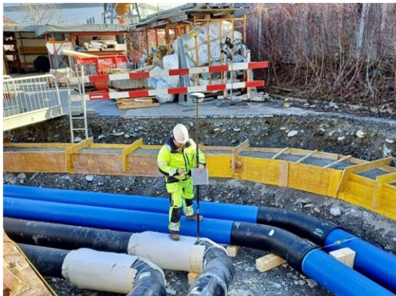
Industriestrasse 18, Aufnahme Wärmeleitung
