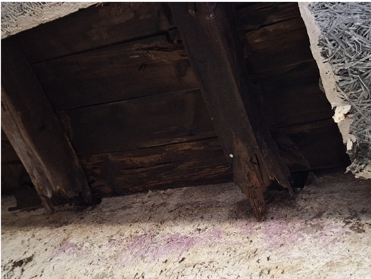
Mehrere durchgefautte Holzbalken Im Werkzeuggebäude
