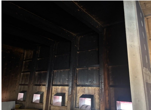
Innenraum Multisammelstelle nach dem Brand vom 12. Juni
