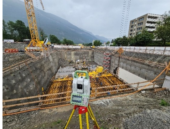
Unterwerk Lacuna, Bauvermessung und Überwachung
