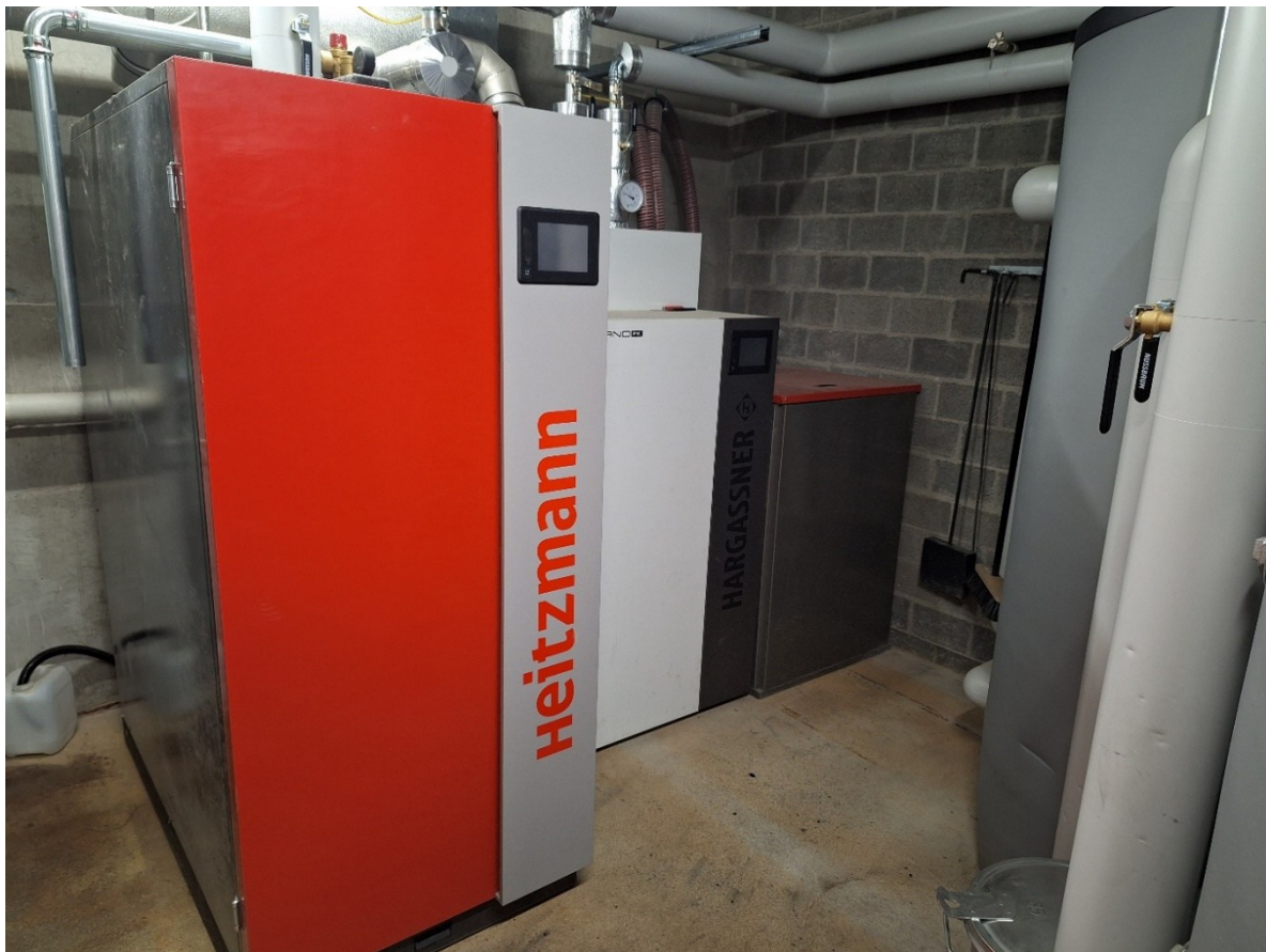
Kombinierte Stückholz-/Pellet-Heizung als Ersatz für Öl-Heizung im Friedhof Fürstenwald
