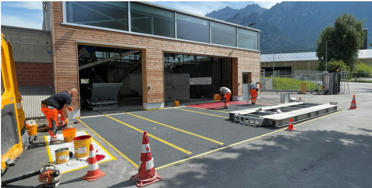
Neue gut sichtbare Beschichtung im Bereich der Gleise Verschiebewagen Rechengut vor dem Rechengebäude
