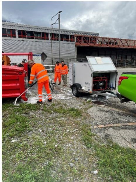
Test durch die Mitarbeiter des Werkbetriebs
