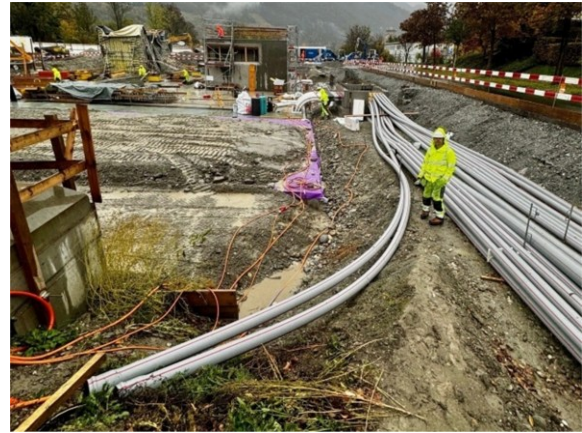
Unterwerk Lacuna, Aufnahme
