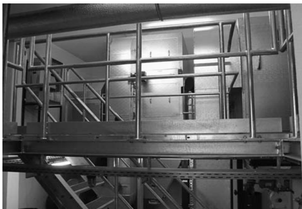
Rauchgasreinigungsanlage im Dachgeschoss des Krematoriums.
