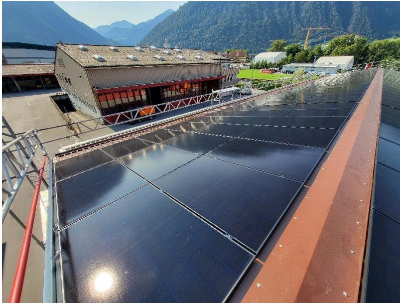
Fotovoltaikanlage Dach Werkhalle
