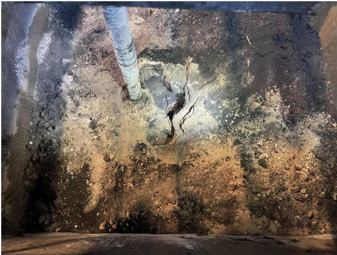
Asche und Kohle im Schlammannahmehunker der TRAC
