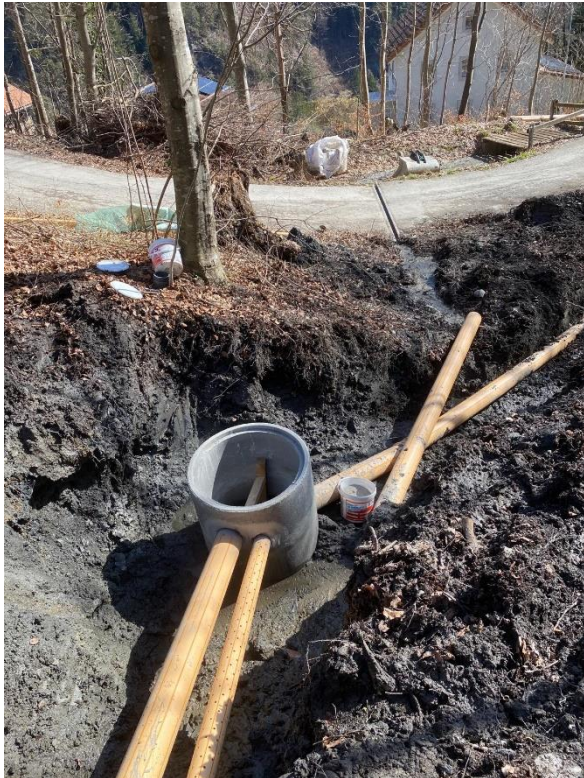
Ersatzleitungen oberhalb Araschgen
