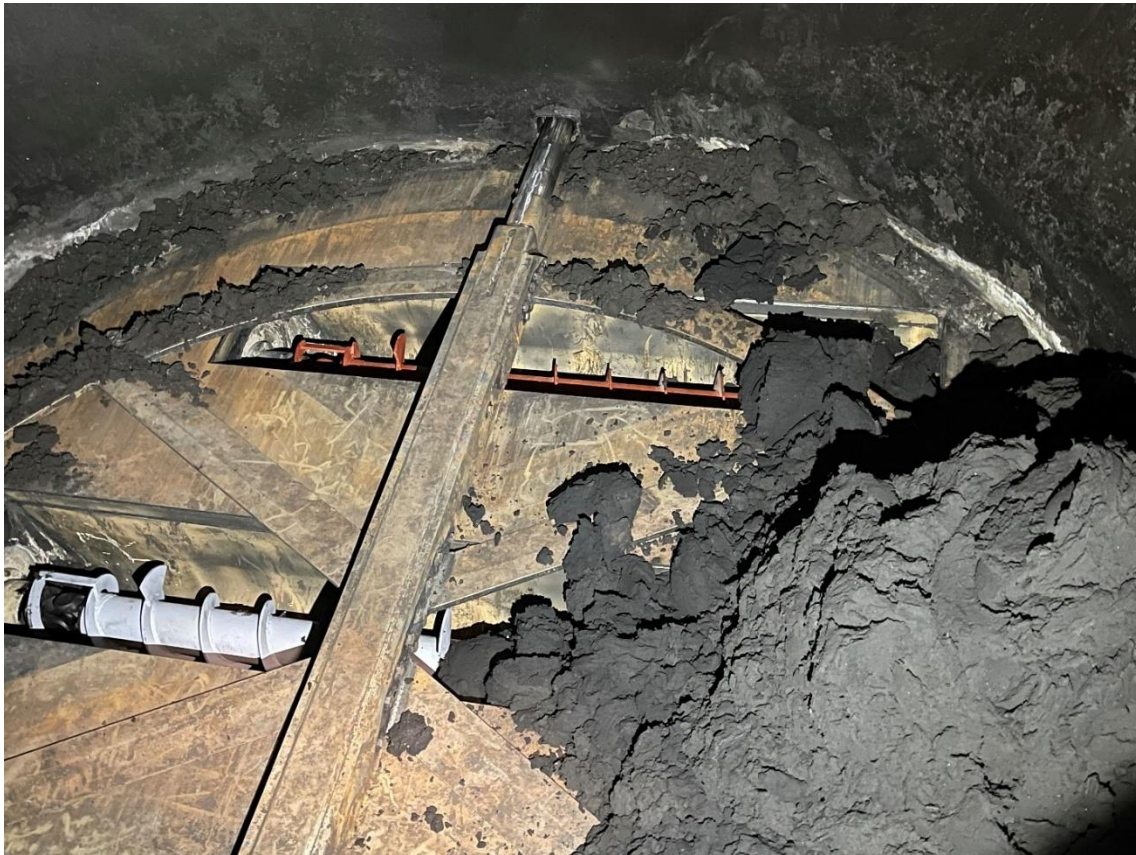
Einzugsschnecken unter dem Boden Speichersilo
