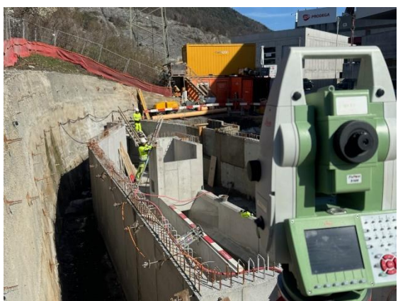
Grossbruggerweg: Aufn. Hochwasserentlastungsschacht
