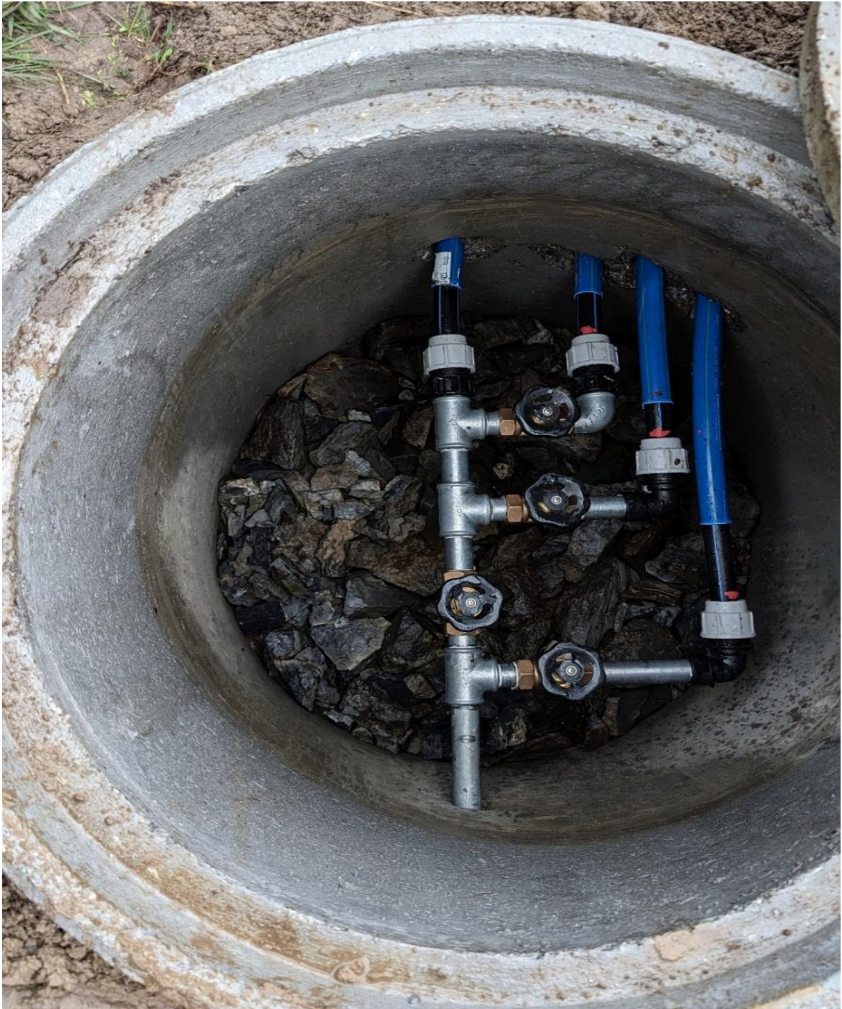
Schacht Wasserversorgung Calanda
