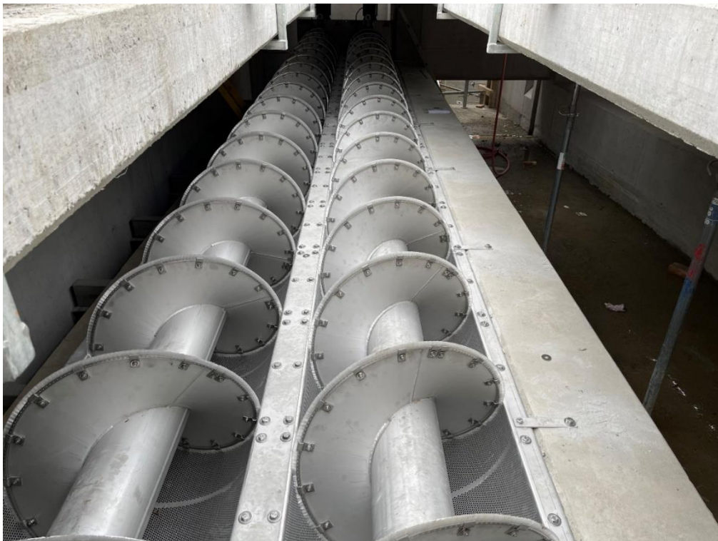
Siebanlage Seite Hochwasserentlastung
