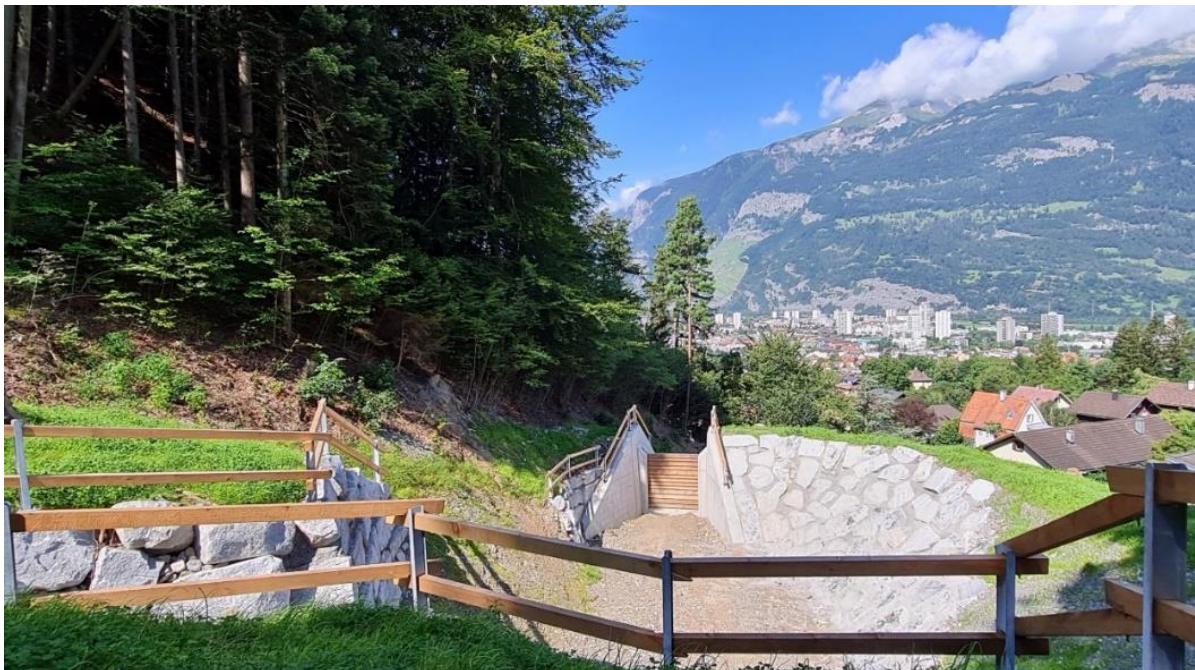
Geschiebesammler Eulengut mit Absturzsicherung
