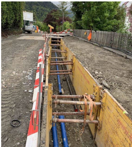
Wasser- und Gasleitung
