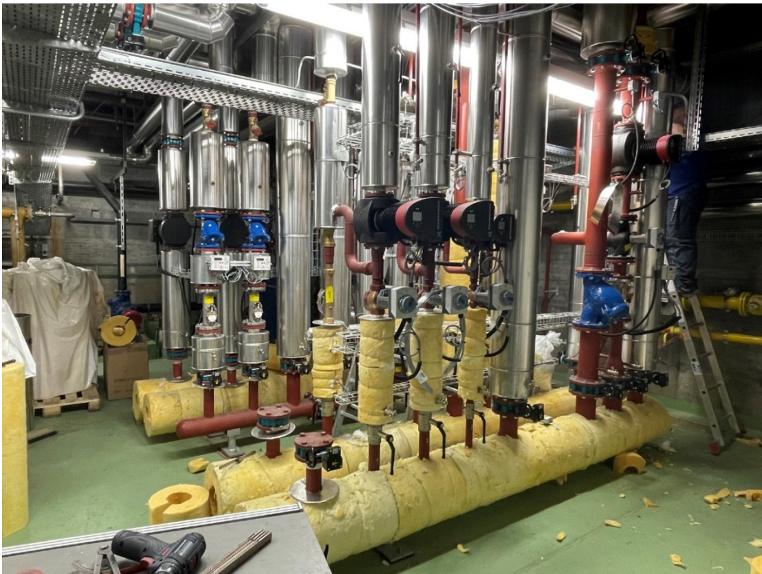
Heizverteilung mit Hoch- und Niedertemperaturwärmetauscher (Hintergrund)
