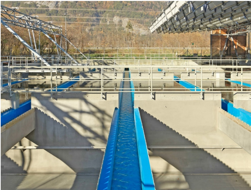
Auslaufrinnen Nachklärbecken mit Epoxidharzbeschichtung
