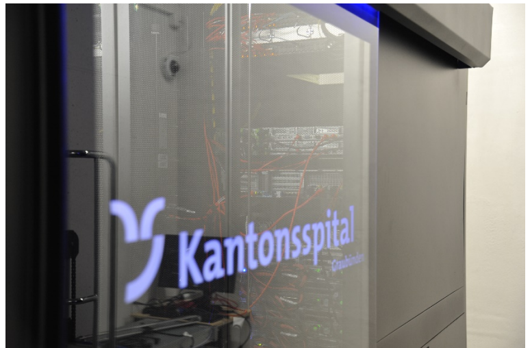
Server im Kantonsspital Graubünden
