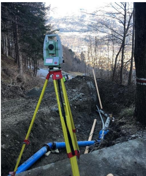
Aufnahme Wasserleitung Araschgerrank
