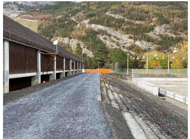
Fluchtweg für neue Notausgänge
