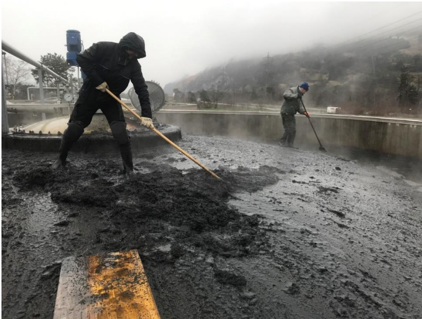
Verdrängen von Schaum, Textilfasern und Verzapfungen auf Dach Faulraum 2
