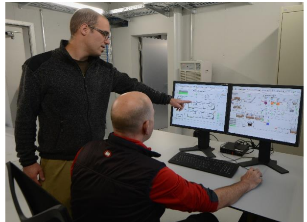
Leitsystem im Betriebsgebäude Regenbecken
