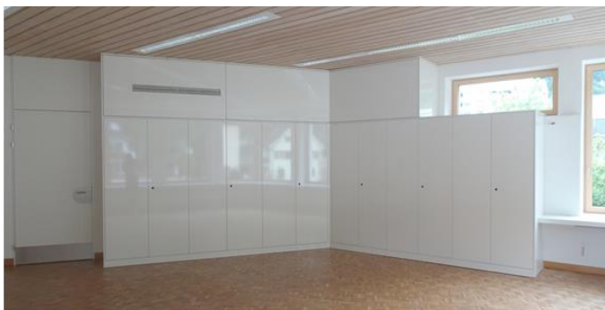
Neue Klassenzimmer mit in den Wand-schränken integrierten Lüftungsgeräten
