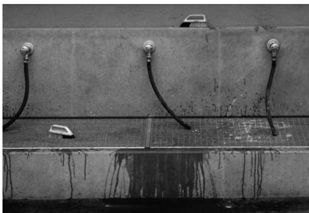
Frostsichere Stiefelwaschanlage, welche das ganze Jahr über genutzt werden kann.
