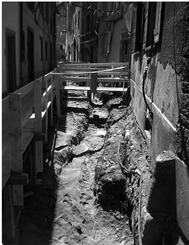
Engste Platzverhältnisse für Werkleitungen.
