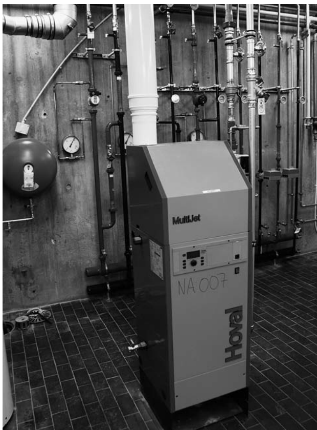
Der neue Haustechnikdemonstrationsraum.
